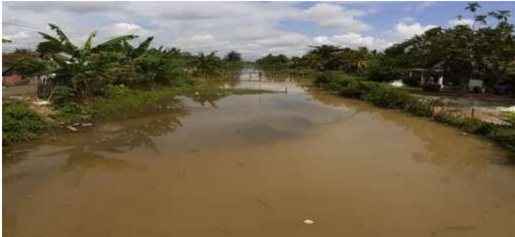
Gambar 4.4. Muka air sungai yang tinggi dan Tebing sungai yang tergerus
