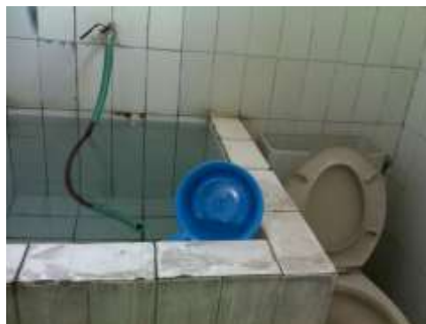
Gambar 4.3 Toilet untuk karyawan wanita di lantai 1
