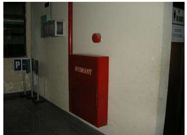
- Hidran Kotak & Alarm
