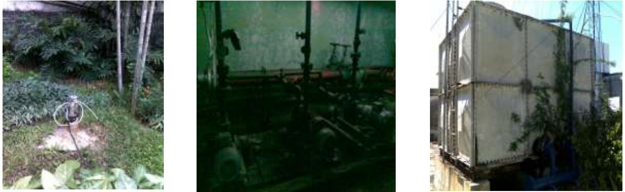
Gambar 4.6 Sumur tidak dilengkapi bangunan pelindung (a); pompa penampung air dan pompa distribusi serta alat control (b); tandon atas (c)
