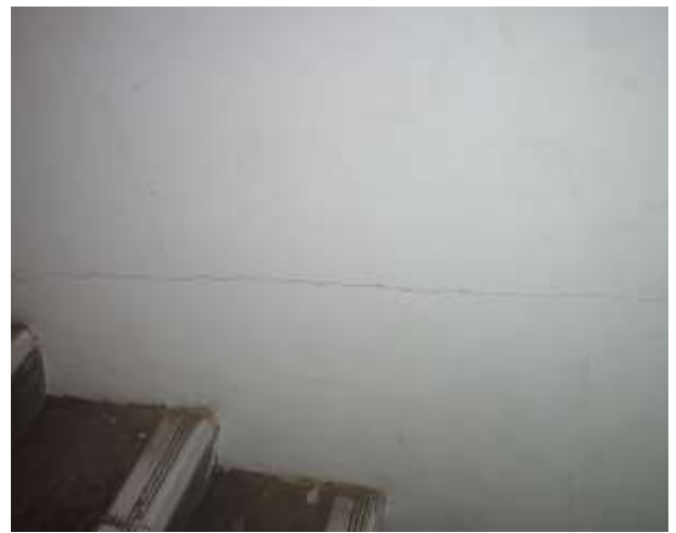
Retak pada dinding
