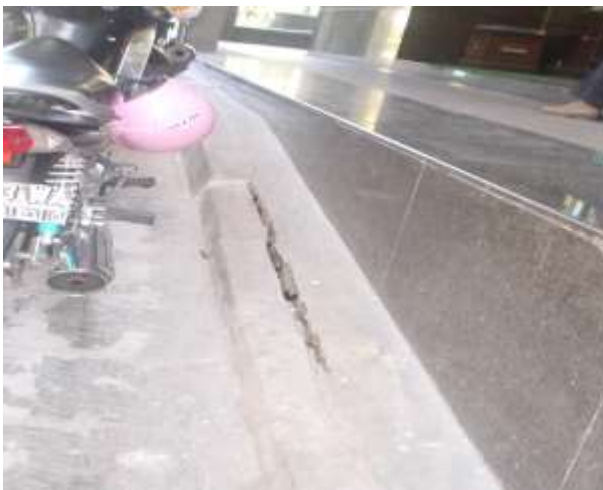
Retak lebar bagian bawah bangunan, indikasi penurunan sebagian bangunan
