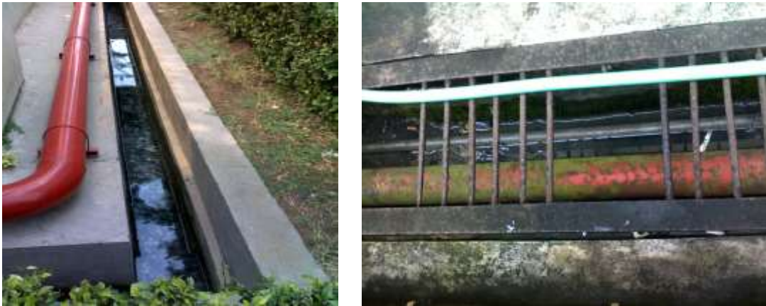
Gambar 4.2 Sistem pembuangan di luar gedung : terbuka (a); penempatan pipa hidran, pipa air bersih yang memungkinkan terjadinya cross connection dengan air limbah (b)
