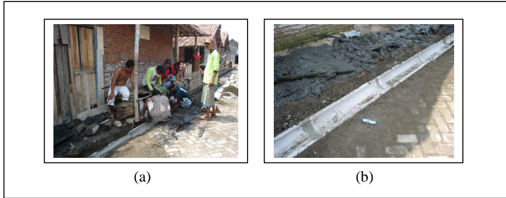
Gambar 5.12. Pekerjaan Pembuatan Drainase : a) Keterlibatan masyarakat dalam kegiatan pembangunan, b). Saluran drainase yang sudah jadi.
