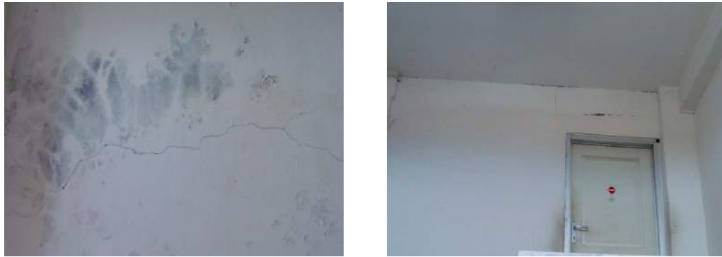
Gambar 2. Retak rambut pada dinding dan plafon
