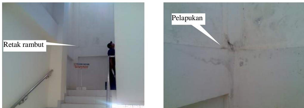
Gambar 1. Retak rambut dan pelapukan pada daerah pertemuan balok-kolom
